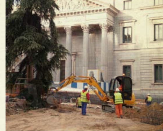
Las obras son el gran peligro de los árboles singulares. Tratados como vulgar mobiliario urbano, la apertura de zanjas y rotura de raíces pueden causar daños irreparables.
